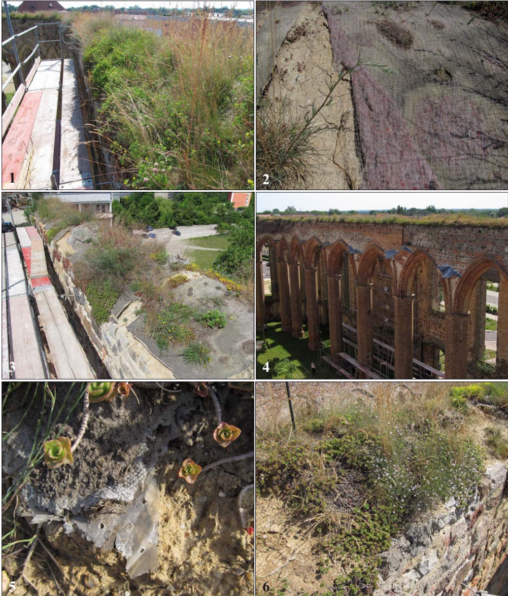
Abb. 1: Südliche Außenmauer, N-Seite (VA 1) mit geschlossener Vegetation ohne Erosion. 7.6.2014.
